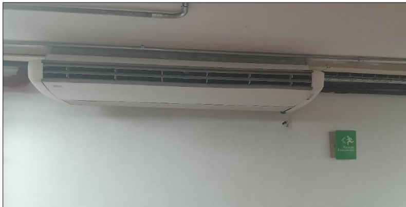
Imagen 1 Aires acondicionados existentes en el Archivo Central.
