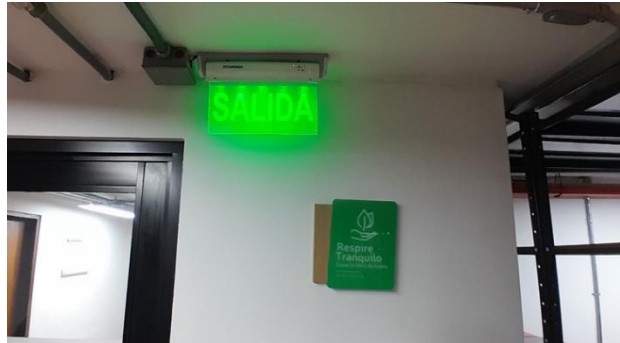
Imagen 3 Alguno extintores y rutas de evacuación con las que cuenta el archivo central del imct.
